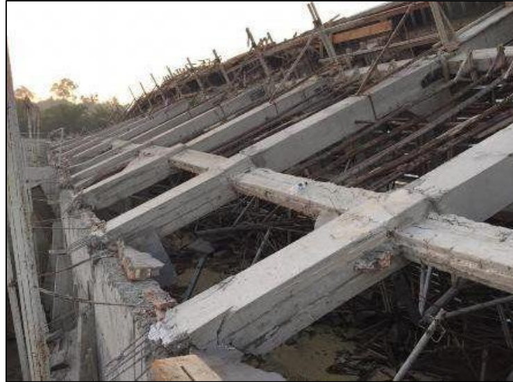
Gambar 4. Robohnya dinding penahan tanah dan struktur atas rumah pompa Dumai, Rokan Hilir, Bengkalis (Duralis) (infopublik.id)
